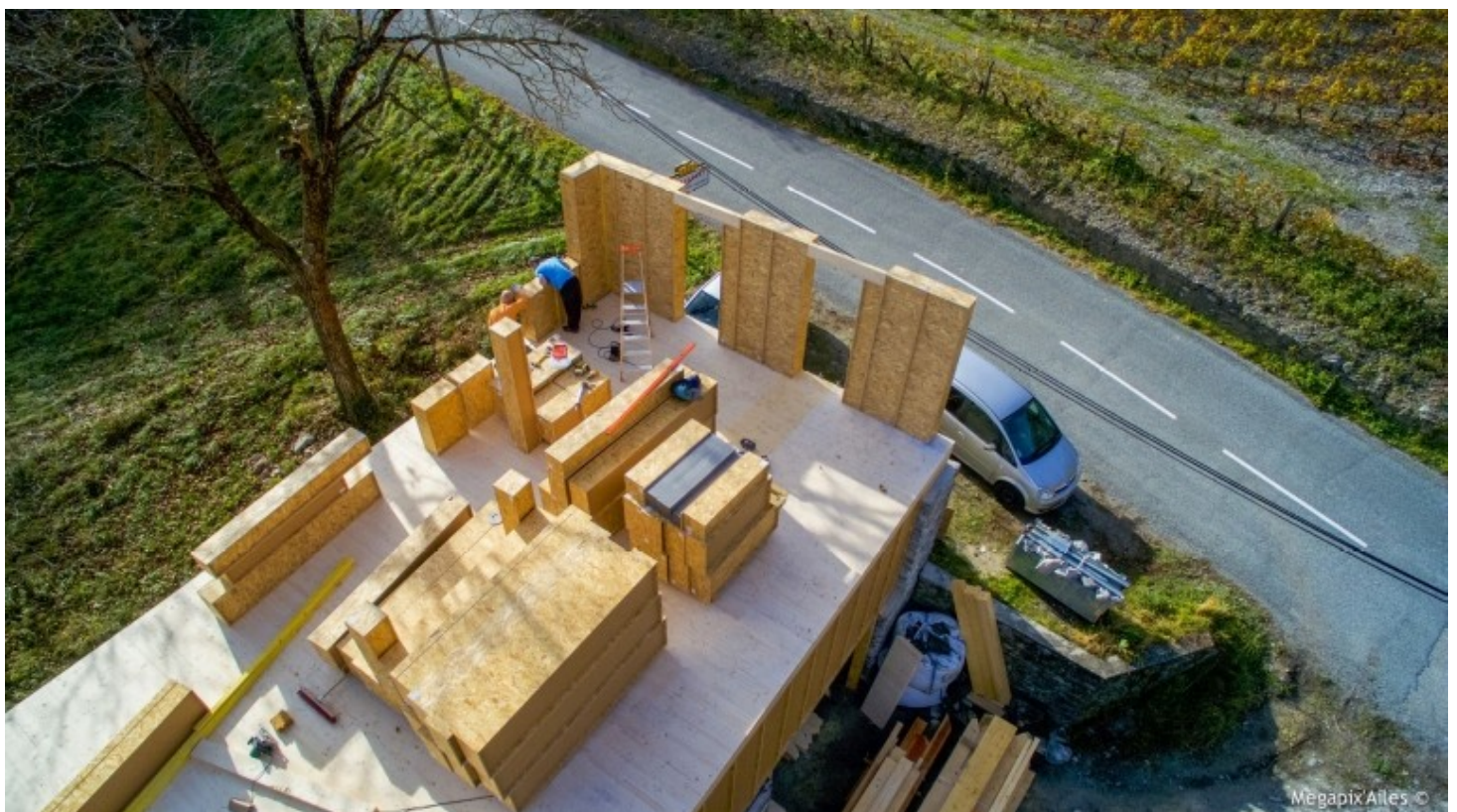
Het belangrijkste aandachtspunt bij het gebruik van Blokwood is dat de muurplaat perfect vlak en haaks dient te liggen
